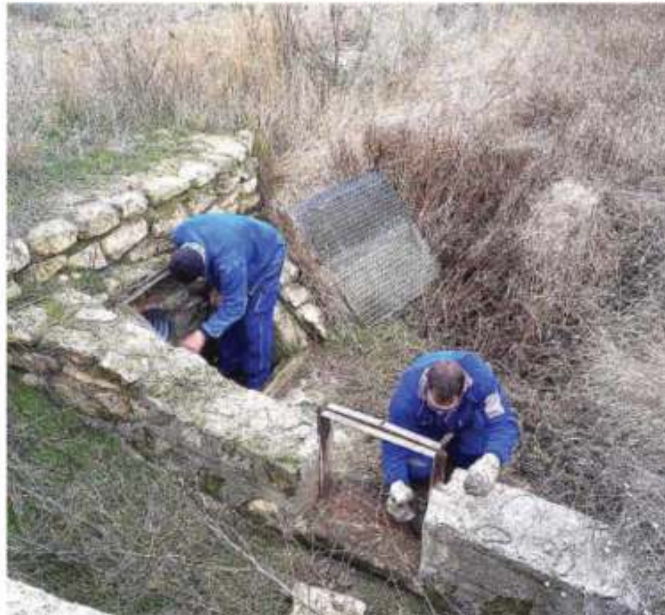
Muchas canalizaciones se encontraban en mal estado. / GLOBAL NATURE
